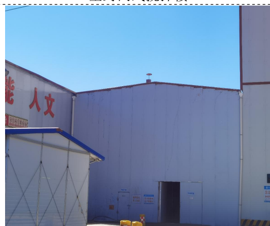
燃油锅炉烟囱 12m
